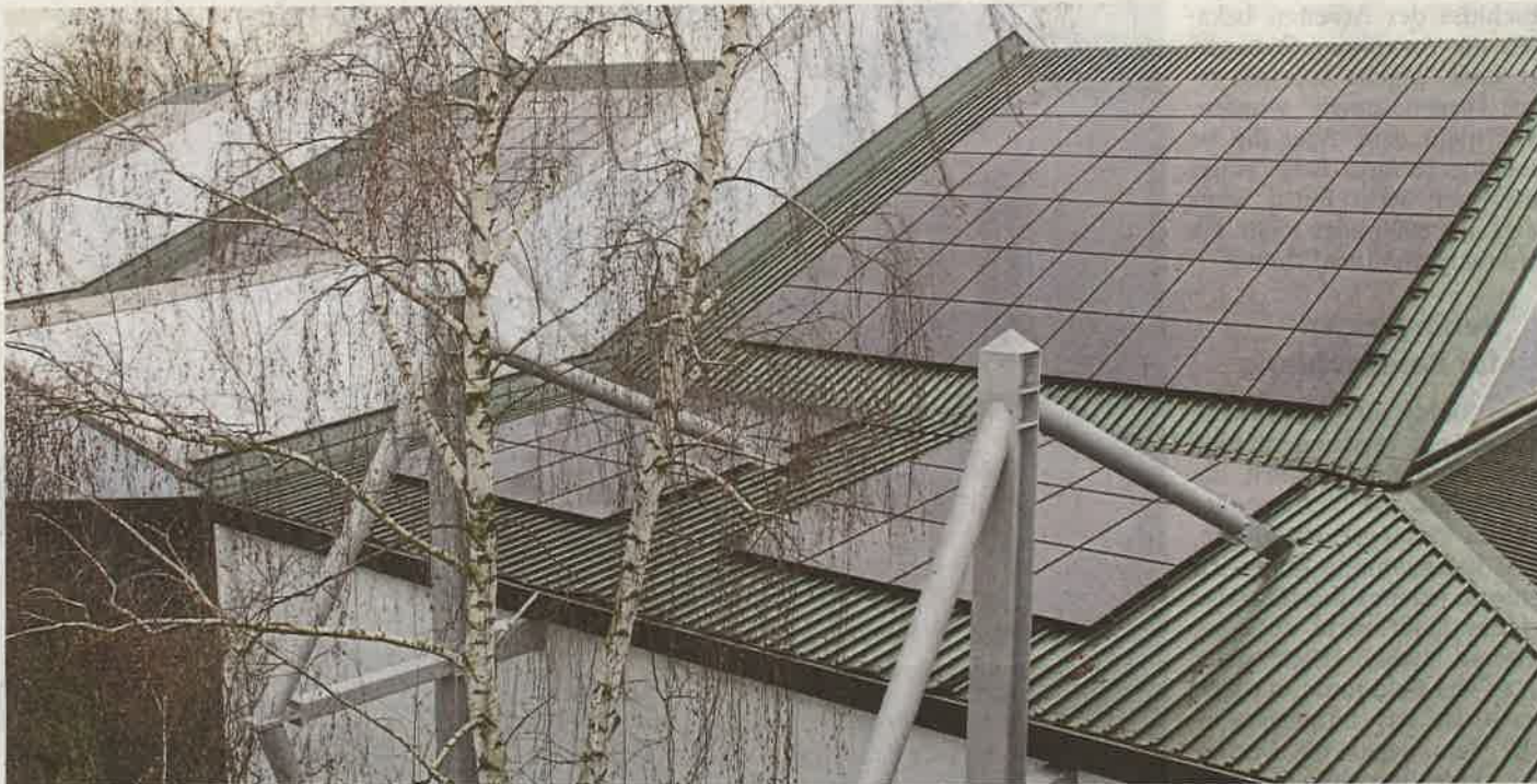
Insgesamt 670 Solarmodule sind auf den Dächern von drei Gebäuden im Sportpark installiert worden. Farblich gut mit der Dachlandschaft abgestimmt, fällt die Anlage dem Betrachter der Häuser kaum auf.
